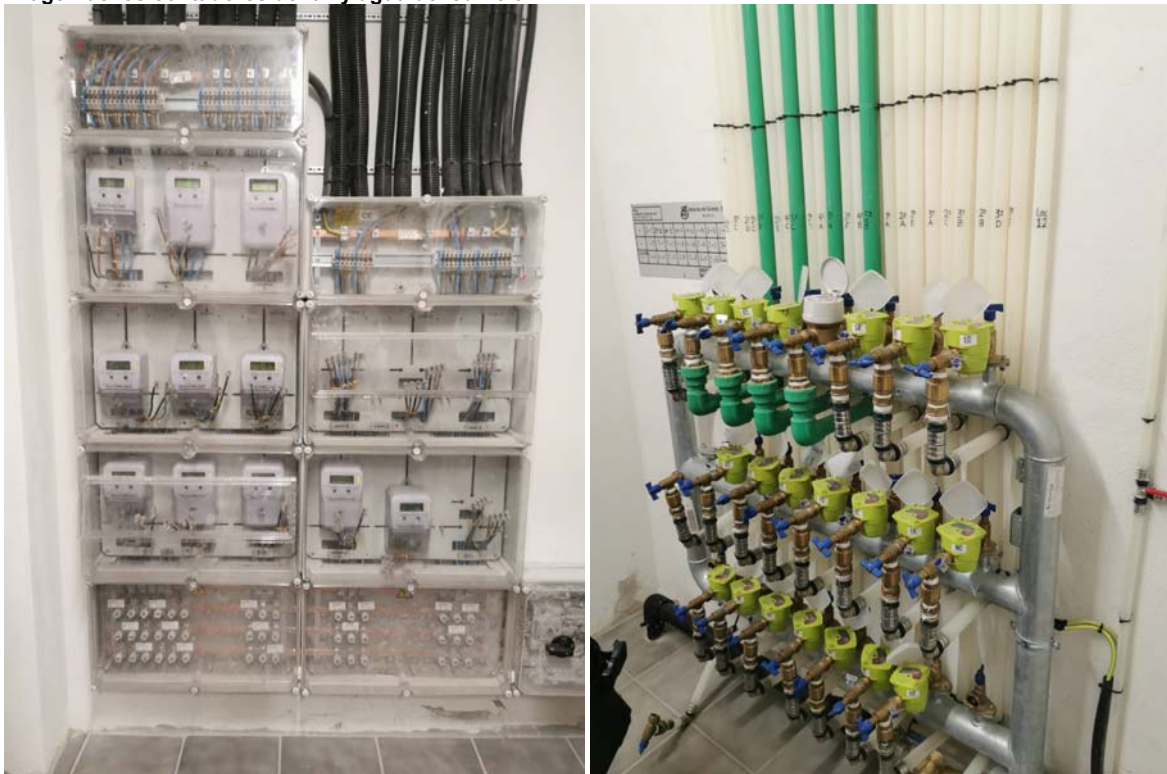
Imagen de los contadores de luz y agua del edificio.
